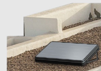
INSTALLAZIONE SUL TETTO PIANO
